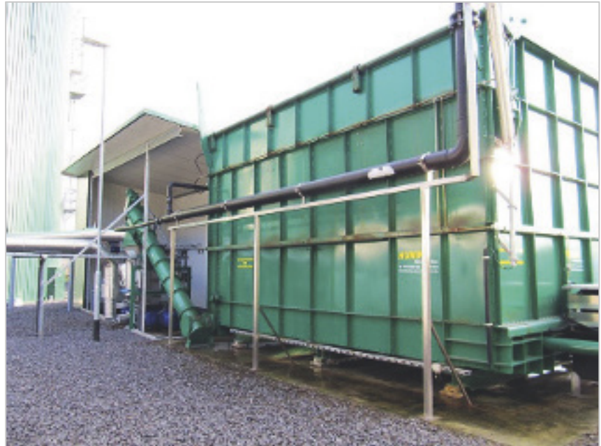
Rohstoffbeschickung der Biogasanlage
