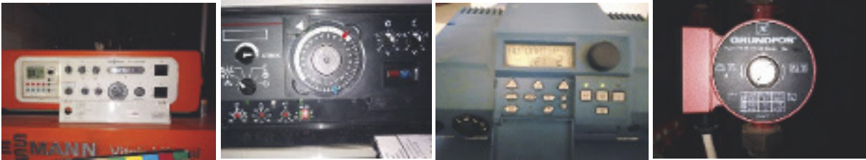
Heizungscheck bei Heizungen
